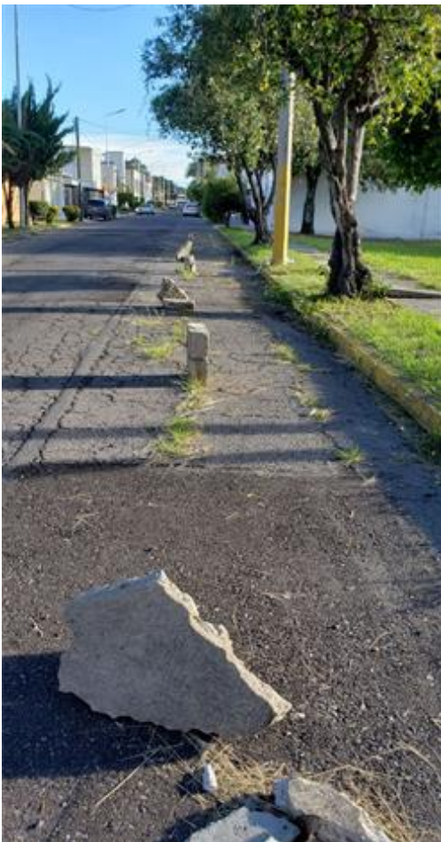
Imagen 4. Falta de accesibilidad
