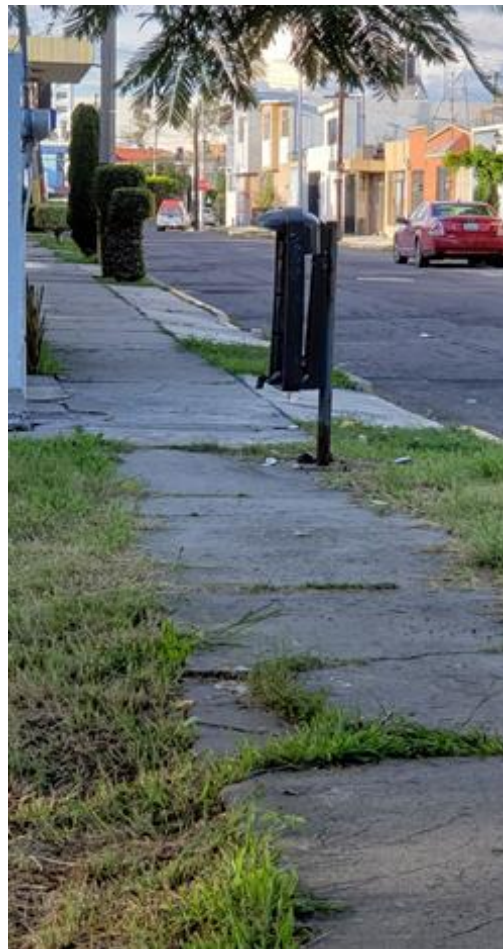
Imagen 5. Falta de servicios
